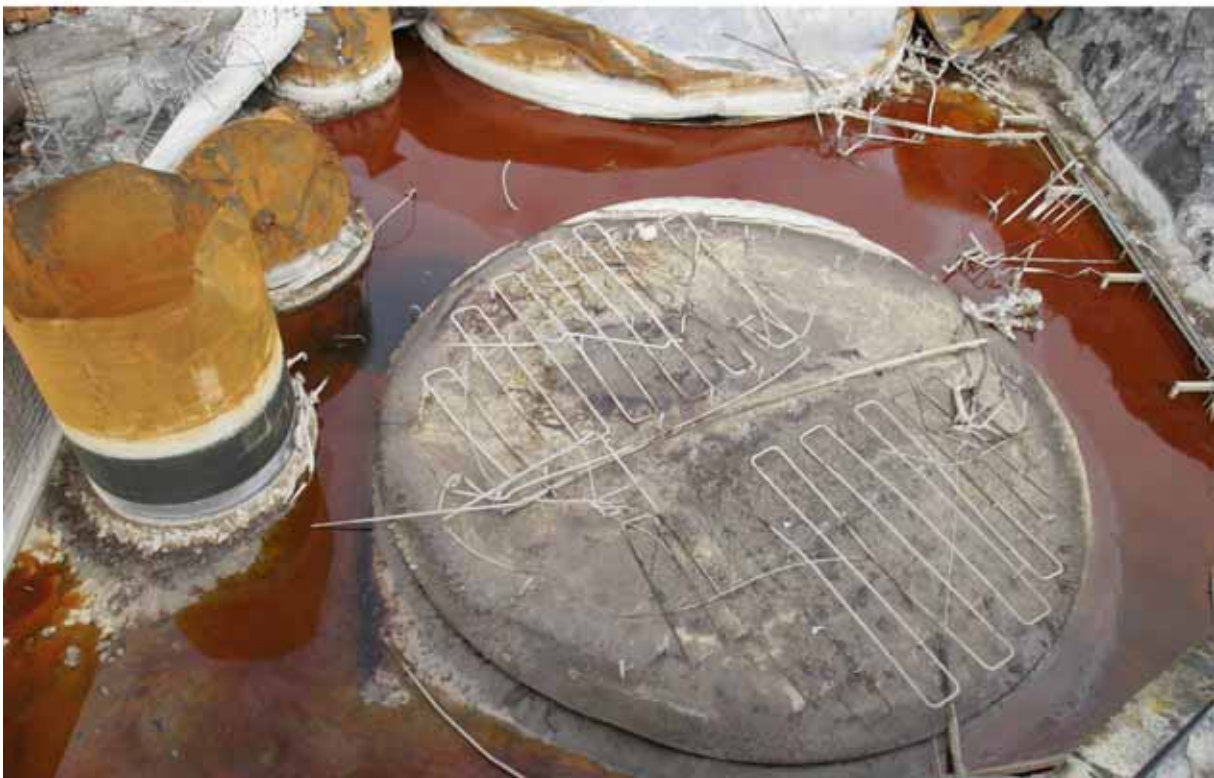
Figur 3-2 Tankgård II sett fra syd (bildene er tatt fra toppen av tank T2, se Figur 1-2): det øverste bildet viser de tre mindre tankene C1-C3 (til venstre langs ringmuren), øvre del av tank T3 (kastet delvis opp på kanten av tankgården – merk at bunnen av T3 er dekket av vann i dette bildet), samt tank T4 midt i bildet (bilde fra Politiet, tatt 25.05.2007). Det nederste bildet viser restene av tankene T3 og T4, her vises bunnen av T3 (med varmerørene) fordi vannet i tankgården er drenert ut (bilde fra Politiet, tatt 31.05.2007).
