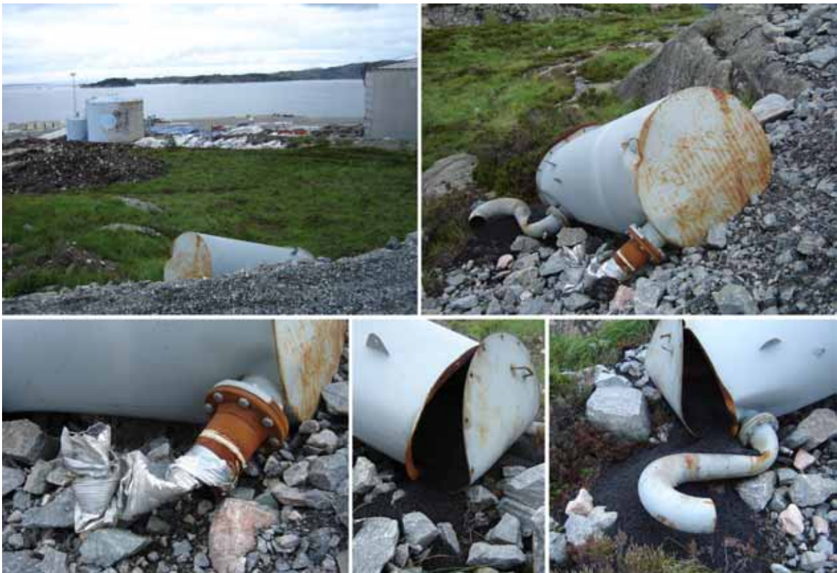
Figur 6-3 Luftfilteret med aktivt kull: plassering i terrenget (to øverste), innløp med rester av fleksibelt rør (nederst til venstre), filtertopp (nederst i midten), og utløp/svanehals (nederst til høyre).
